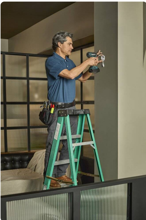
▲ Sonos Era 100 Pro Instalacion.JPG
