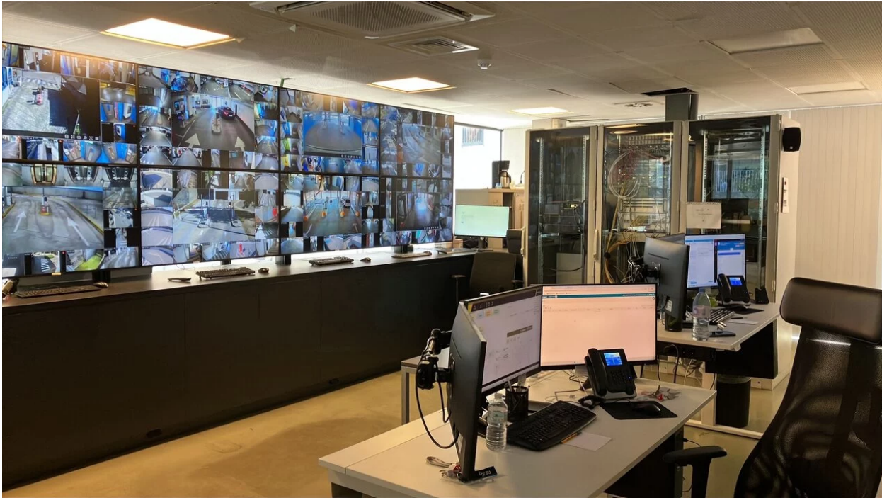
▲ De nieuwe controlekamer in Parking Ramen.
